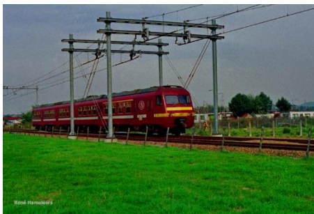
Deel van een spanningsluis. Tussen de twee portalen hangt geen bvl-draad en is dus spanningsloos
