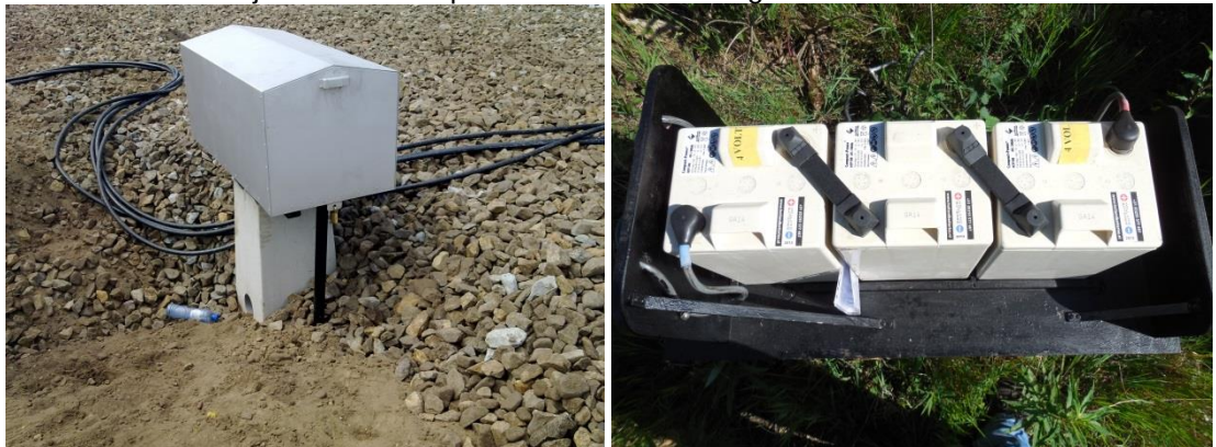
Batterijkast en accu's in batterijkast.
