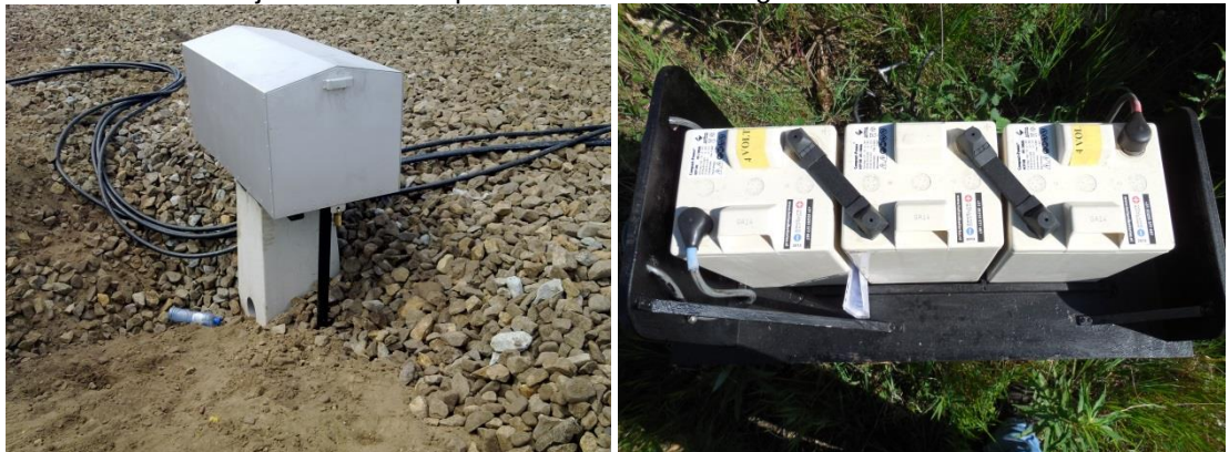
Batterijkast en accu's in batterijkast.
